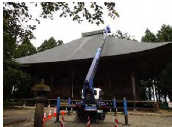
写真5 薬師堂屋根雨漏り確認調査の様子 クレーン車を使って、屋根の外側を確認しています。
